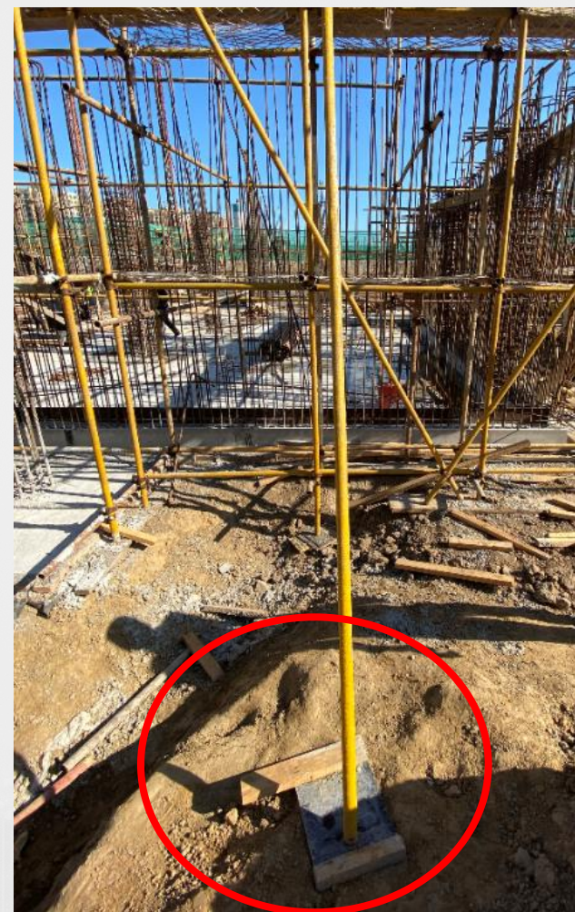
脚手架抛撑未正确固定
