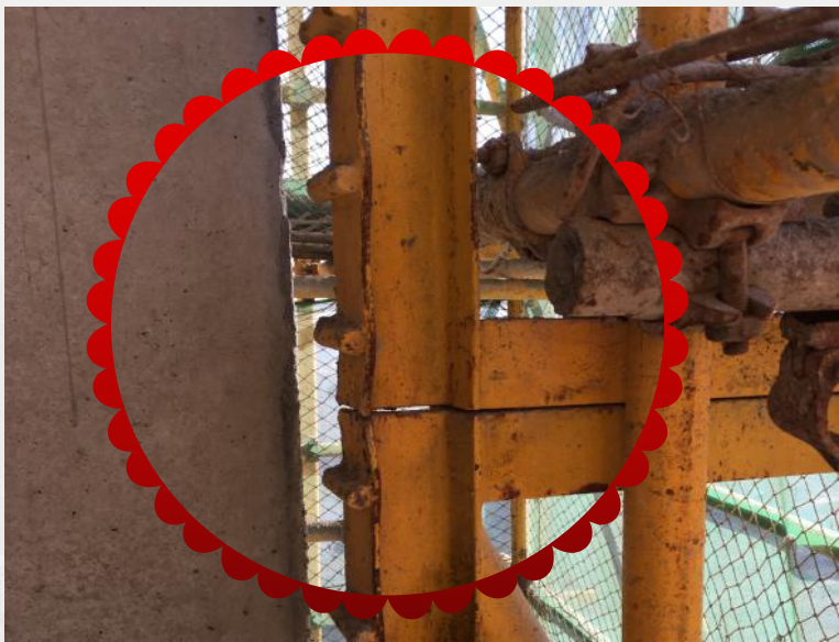
主框架变形严重
