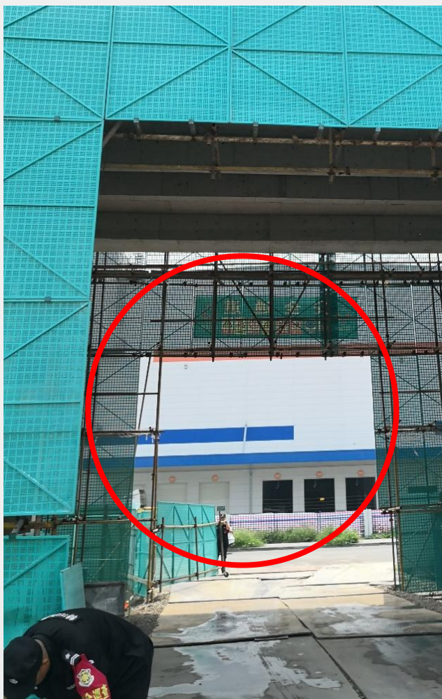
脚手架门洞开设不合理
