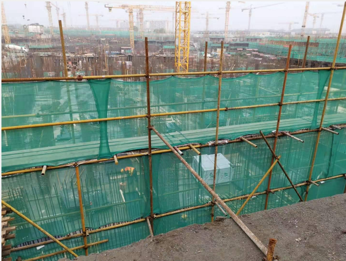
脚手架作业面未设置挡脚板，主节点位置未独立设置小横杆
