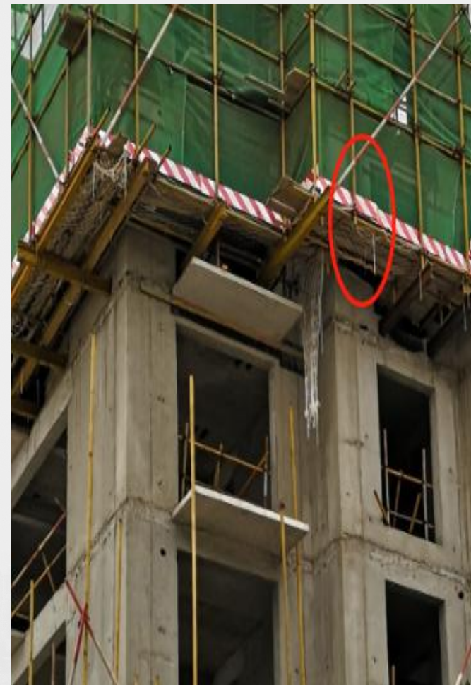
型钢悬挑架立杆悬空
