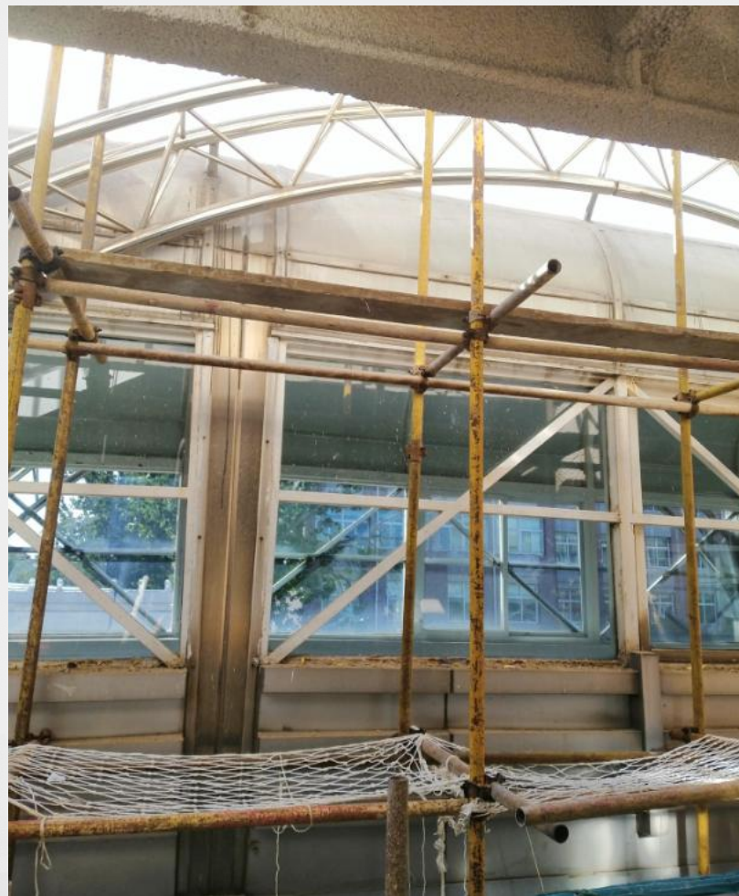
作业层无防护，单板作业
