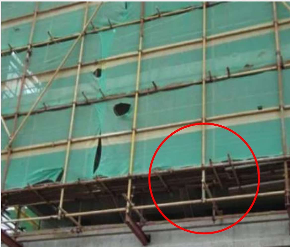
立杆下方未设置悬挑梁
