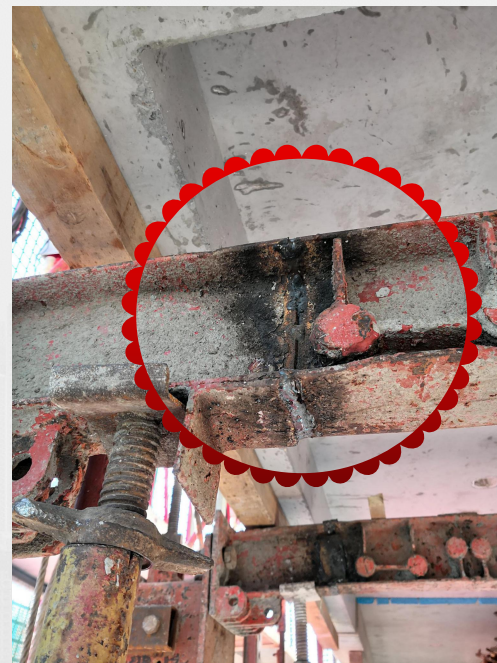
附着支承结构焊接 质量不合格
