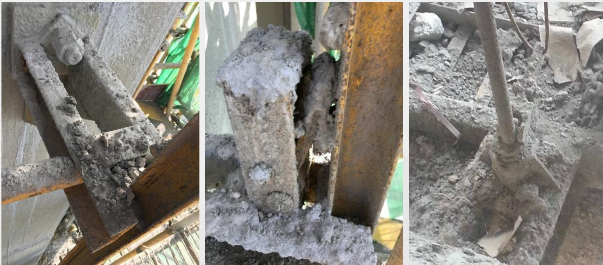
支座、提升装置等污染严重，防坠装置失效
