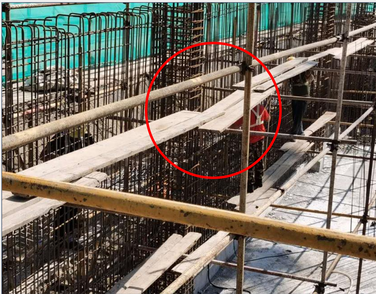
脚手板铺设存在单板、跳板、脚手板未固定等现象
