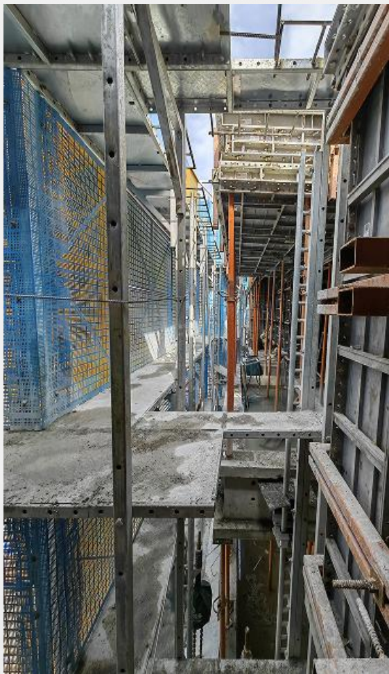
作业层防护不到位
