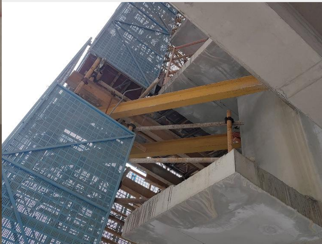
型钢悬挑架锚固长度不足
