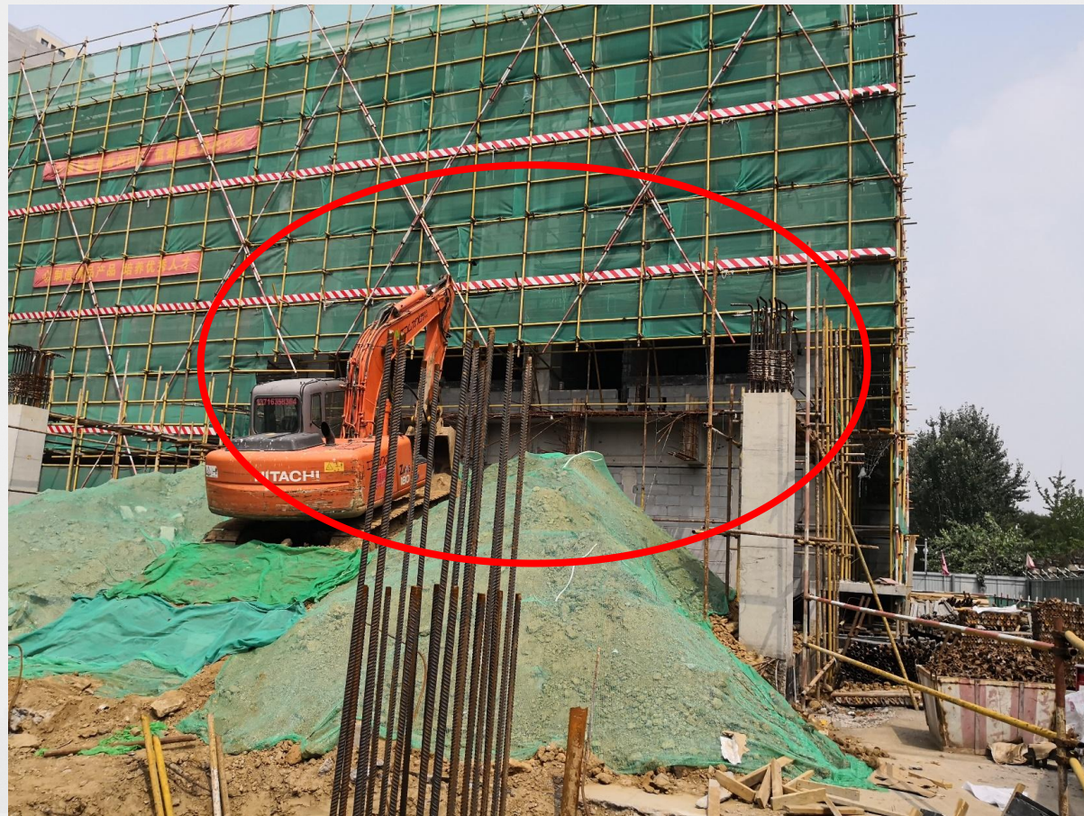
立杆随意拆除
