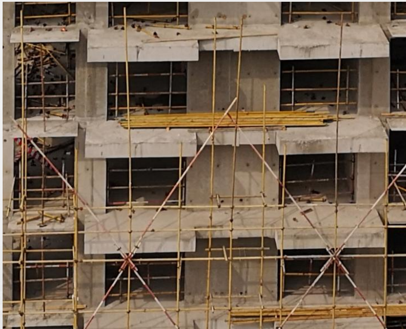
脚手架拆除时，拉结点提前拆除
