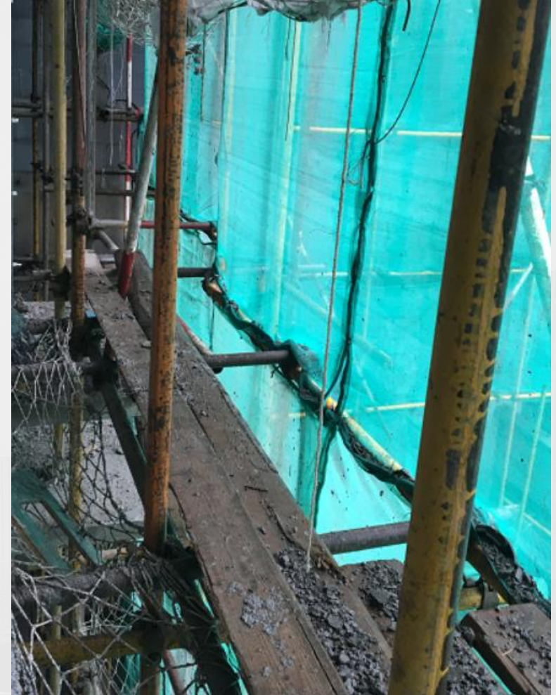
脚手板未满铺固定
