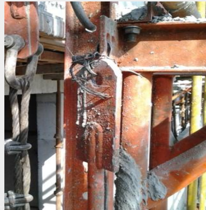
钢吊杆未安装
