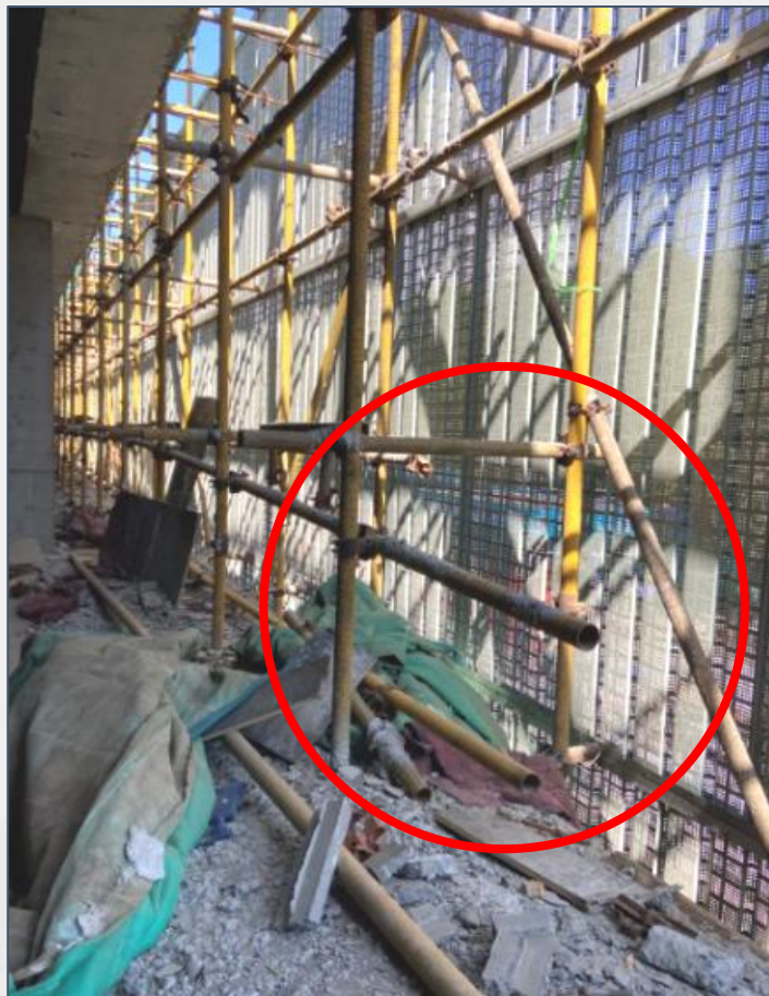
大横杆存在断开处
