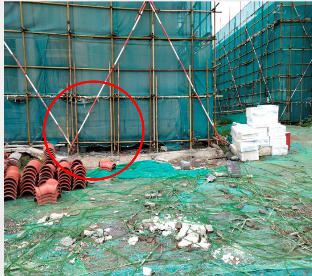
双排脚手架立杆悬空
