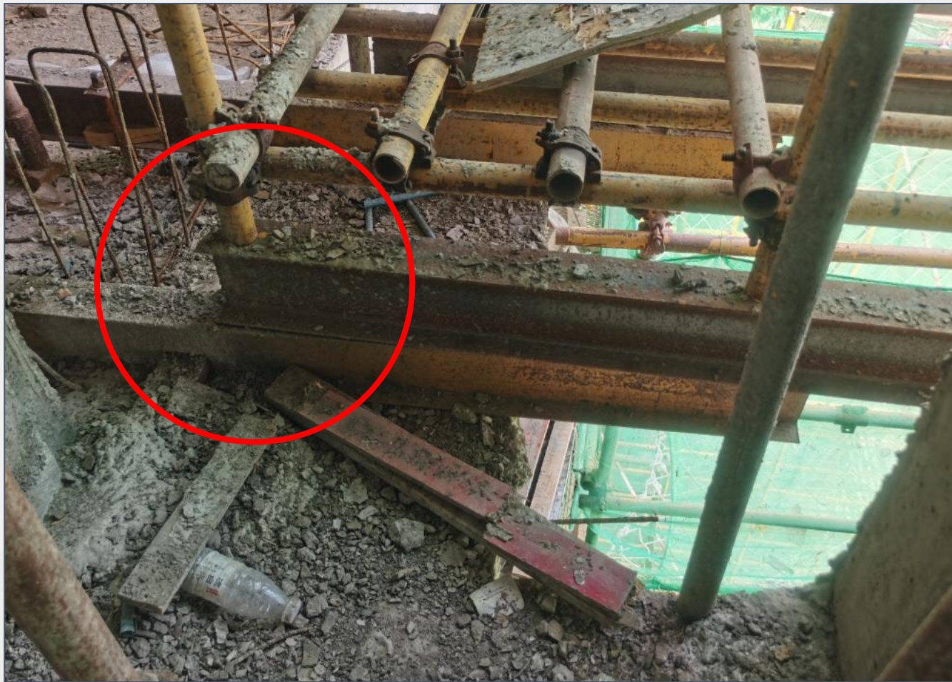
悬挑梁搭接未锚固，立杆无定位杆
